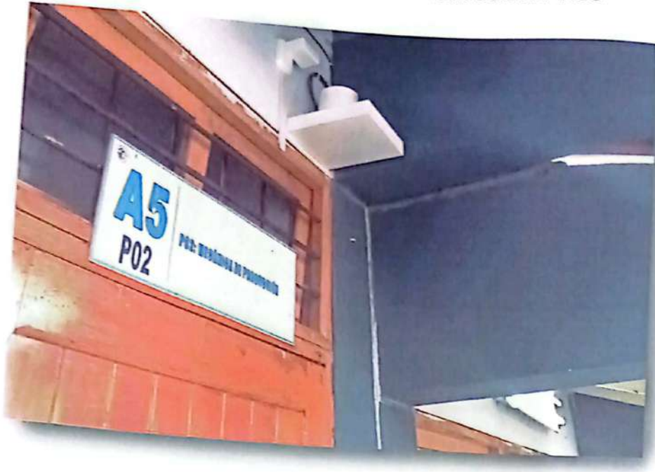
Imagen 02: Instalación de equipos Mesh con SSID: MARCO
