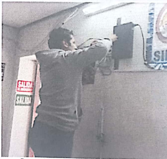
Organizando el cableado de red
