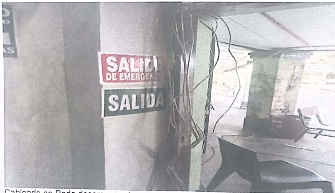
Cableado de Rede desorganizado
