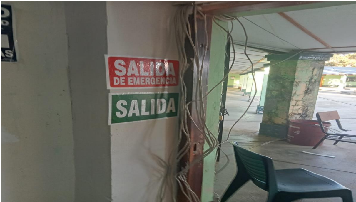
Cableado de Rede desorganizado
