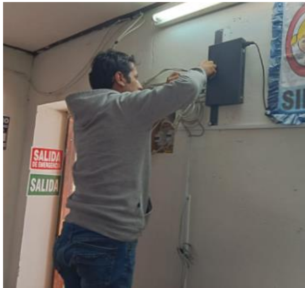
Organizando el cableado de red
