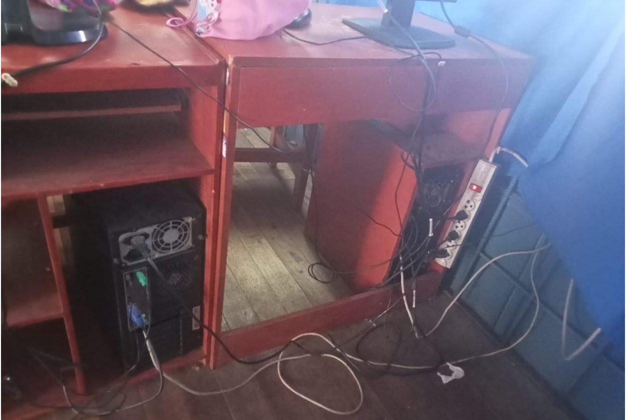
Conductores de la parte de atrás del CASE desorganizados
