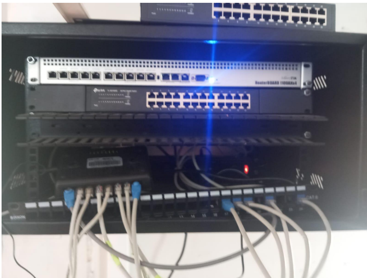
Switich inoperativo se esta utilizando un switch pequeño como alternativa
